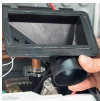
Ispezione raccolta condensa
