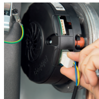
Disconnessione elettrica ventilatore
